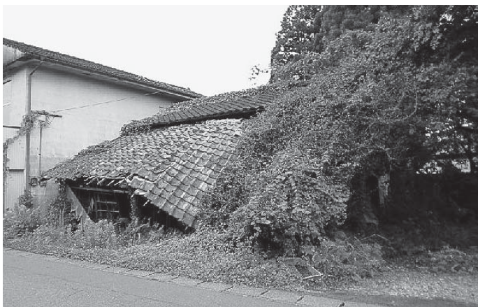
錦町にも廃屋対策条例を
