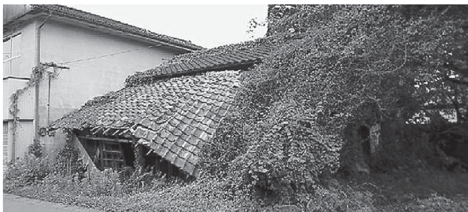
放置された危険な廃屋
