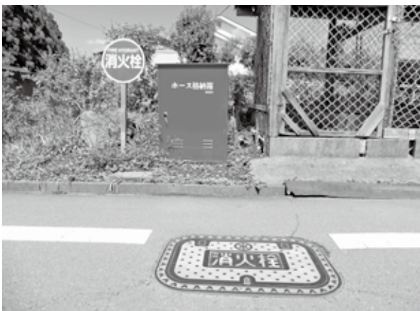
消火栓に併設されたホース格納箱
