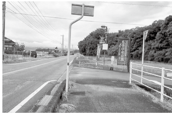
歩道未整備の区間
