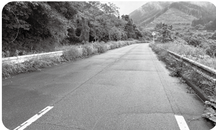
白線が消えている南部農道
