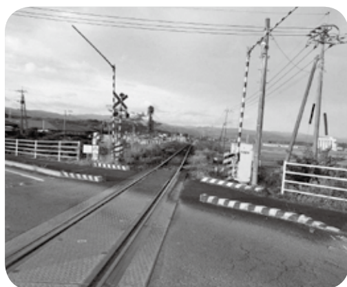
雑草などが繁茂する沿線の法面
