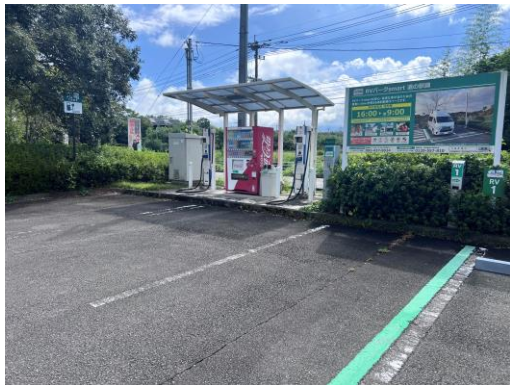
⑨ E V 充電スペース ※令和8年度機器入替え予定
